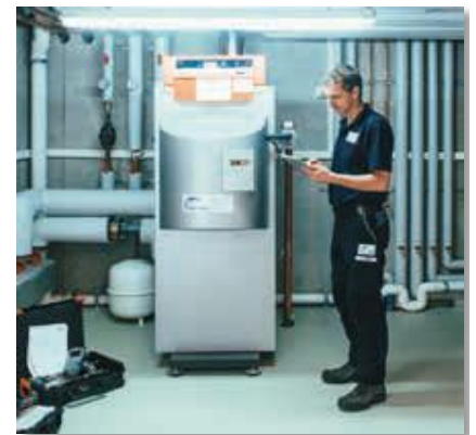
Ein moderner Gas-Brennwertkessel in Kombination mit Biogas trägt zur Einhaltung des Erneuerbaren-Wärme-Gesetzes bei.
